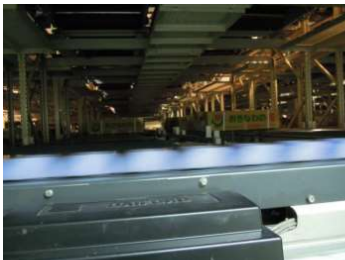
ソーター内仮置きレーン
